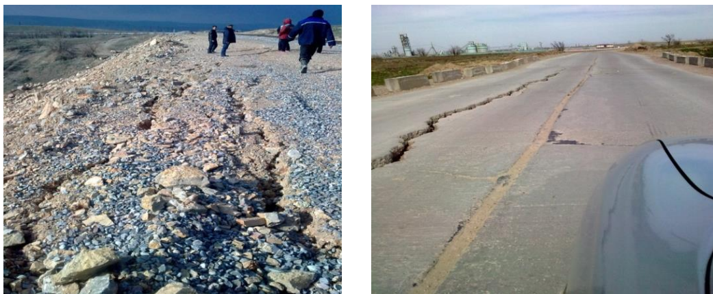
Рисунок 6. Деформации грунтовых насыпей под автодороги
