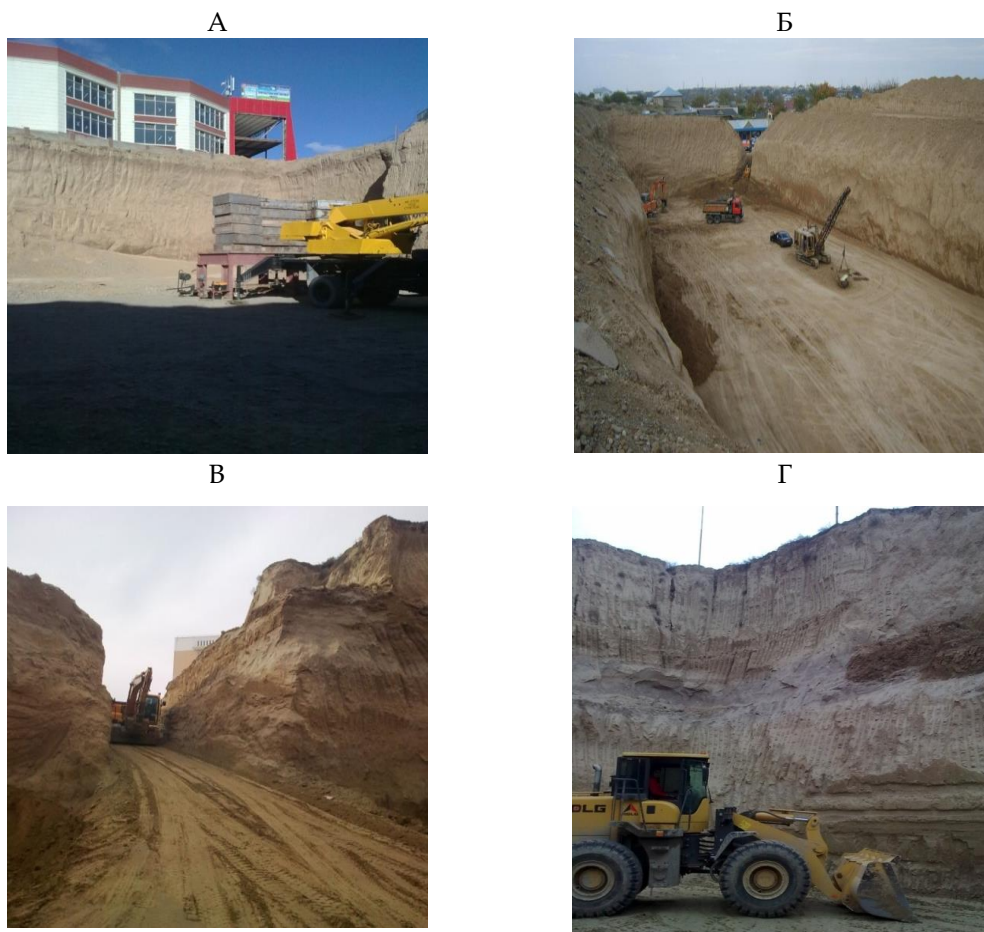
Рисунок 7. А – пример устройства котлована вблизи существующего здания с вертикальным устройством откосов; Б – котлован с выполаженными откосами под 16-этажное здание; В, Г – котлован с вскрытым слоем супеси Примечание – фото автора (Бровко И.С., 2024)
