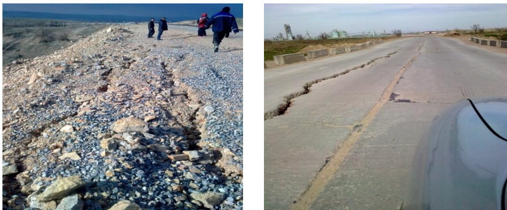
Рисунок 6. Деформации грунтовых насыпей под автодороги
